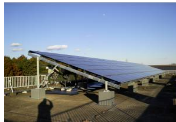
太陽光発電設備20KW
