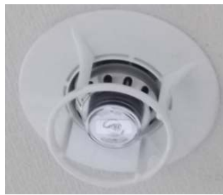
永国長寿館 スプリンクラーヘッド
