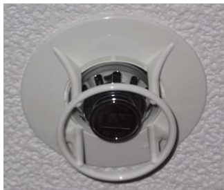
土浦マロン館 スプリンクラーヘッド
