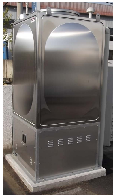
永国長寿館 スプリンクラー 消火ポンプユニット
