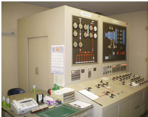
電気設備（制御盤）
