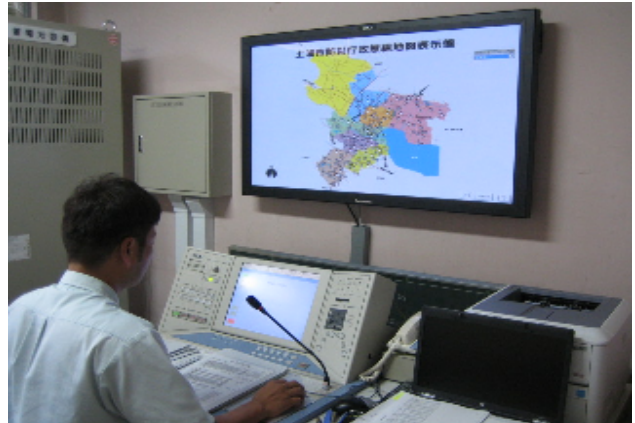
防災行政無線 「通信局設備」
