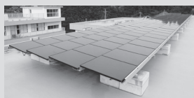
太陽光発電システム
