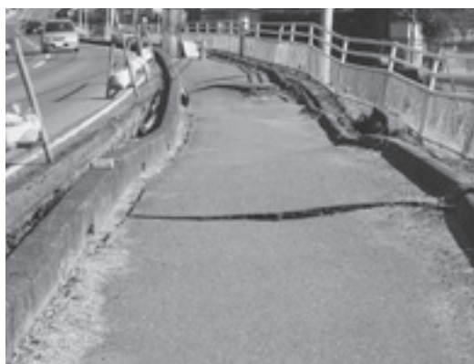
液状化した歩道。左の車道の高さと比較すると、どれだけ陥没したのかが分かる。(新治地区)
