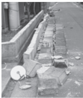
倒壊した塀。墓石、灯籠なども倒れた。 (六中地区)
