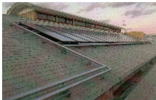
新治総合福祉センター太陽光集熱パネル
