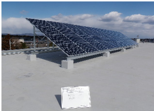
中村小学校太陽電池パネル
