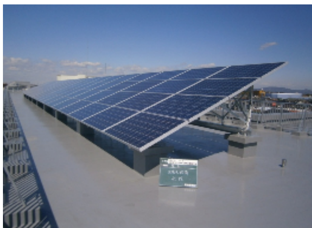
土浦第三中学校太陽電池パネル
