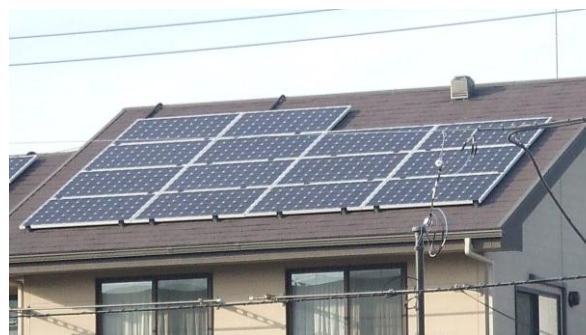
太陽光発電システム
