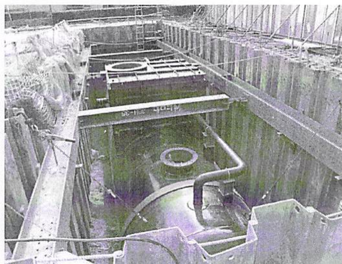
飲料水兼用耐震性貯水槽の設置状況
