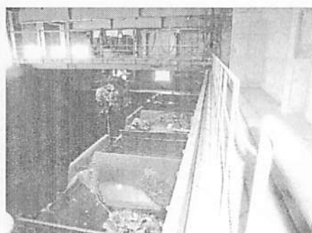
クレーン走行レール
