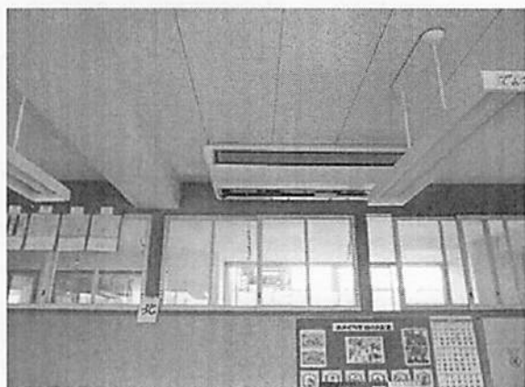
設置エアコン室内機（神立小学校）
