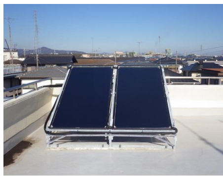
神立消防署太陽熱温水器
