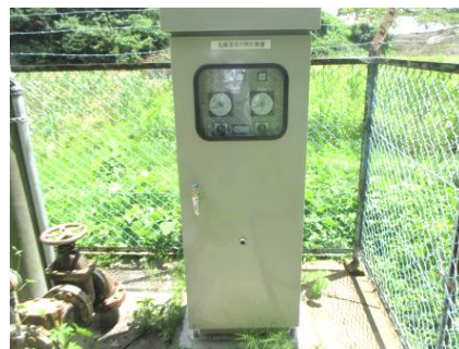
右廻揚水機場制御盤
