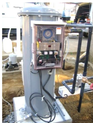
井戸浄水装置
