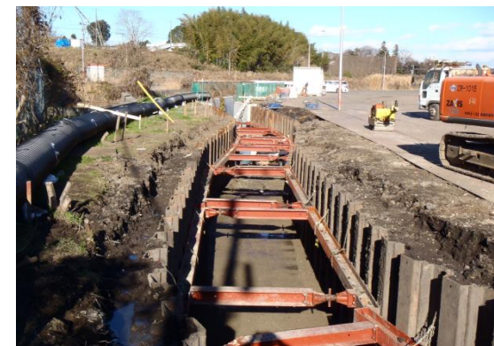
西根竹の入都市下水路整備状況
