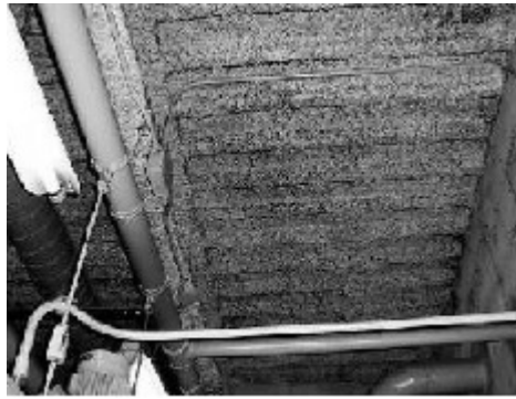
石綿含有吹付けロックウール
