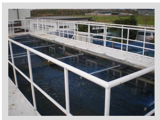
【虫掛生活排水路浄化施設】
