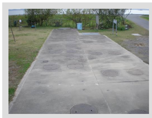
【沖宿地区生活排水路浄化施設】
