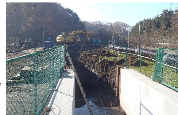
西根竹の入都市下水路整備状況
