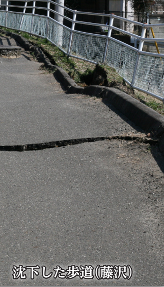
栄利橋付近の道路に入った亀裂(藤沢新田)
