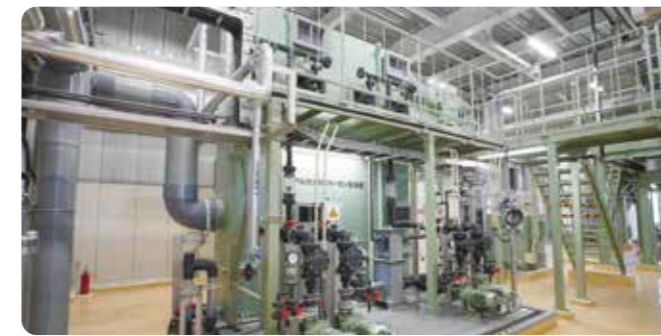
水洗浄・アルカリ次亜カーボン洗浄塔
