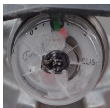
× 指示圧力計の損傷
