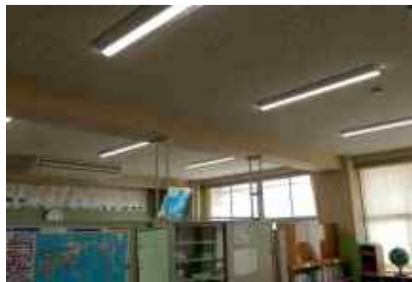
土浦第五中学校 LED照明器具
