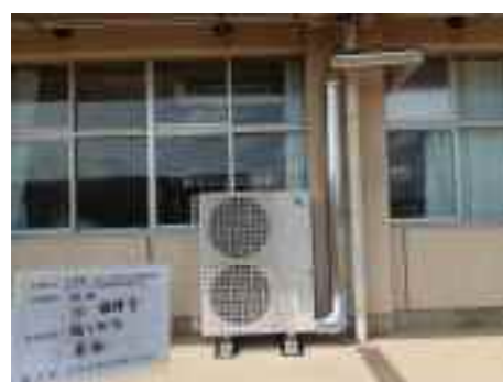
設置エアコン室外機 (土浦第四中学校)
