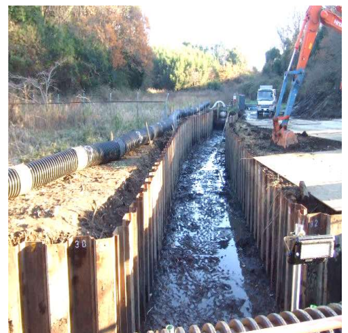
西根竹の入都市下水路整備状況
