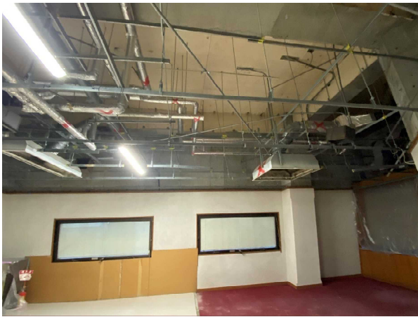
配管が露出した事務室
