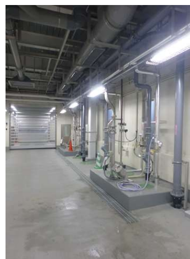
汚泥再生処理センター受入室
