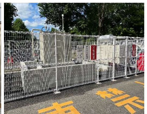
非常用発電設備の設置
