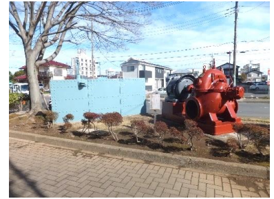
旧川口川閘門鉄扉及び排水ポンプ
