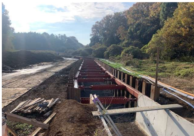
西根竹の入都市下水路整備状況
