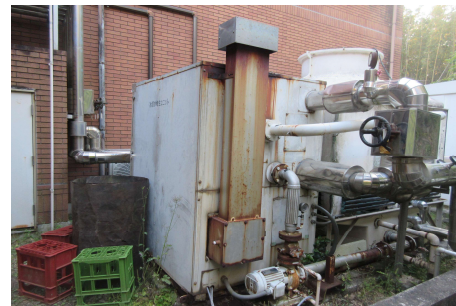
改修対象の空調機器(冷温水発生ユニット)
