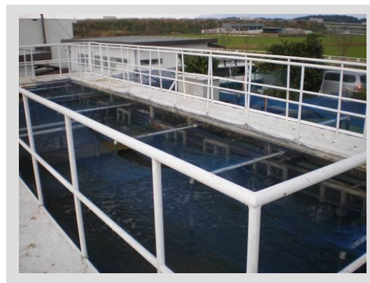
【虫掛生活排水路浄化施設(撤去済)】
