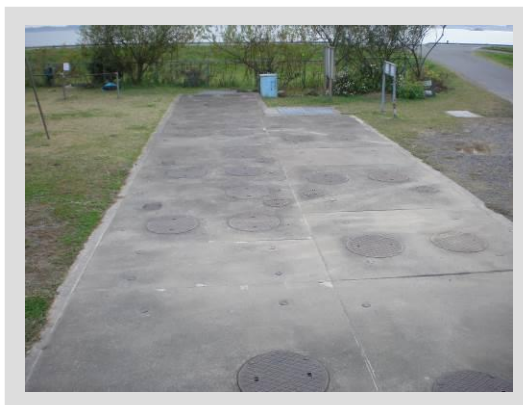
【沖宿地区生活排水路浄化施設】
