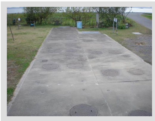
【沖宿地区生活排水路浄化施設】
