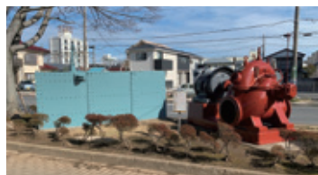
川口川閘門鉄扉と排水ポンプ
