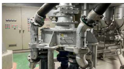
消石灰定量供給装置
