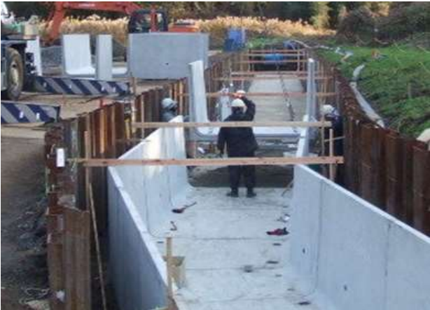
西根竹の入都市下水路整備状況
