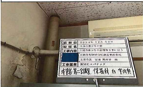
本館 第二会議室 1階 室内奥 配管(白) 保温材 採取後
