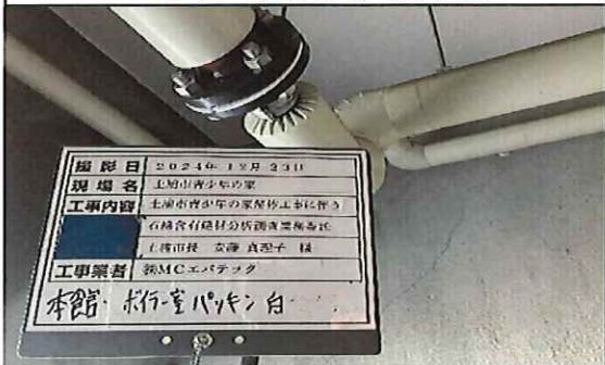
本館 ボイラー室 1階 配管 パッキン(色;白)① 採取後
