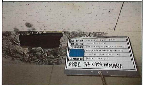
研修室 男子洗面所 1階 天井破損部分 ボード 補修は無し
