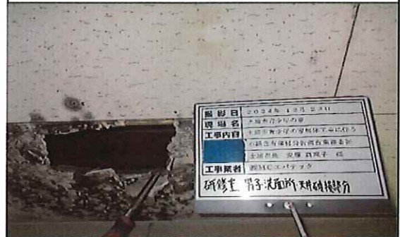
研修室 男子洗面所 1階 天井破損部分 ボード 採取中
