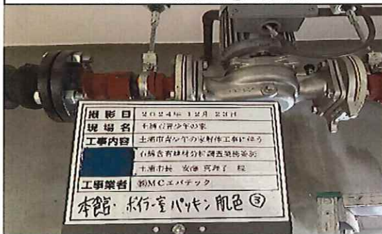
本館 ボイラー室 1階 配管 パッキン(色;肌色)③ 採取後
