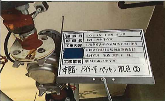
本館 ボイラー室 1階 配管 パッキン(色;肌色)② 採取後
