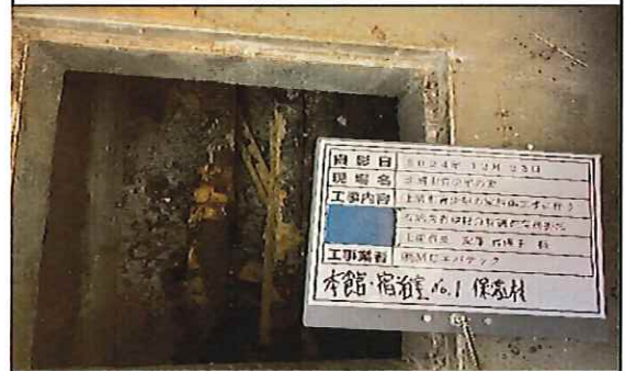
本館 宿泊室No.1 1階 床下配管 保温材 補修は無し
