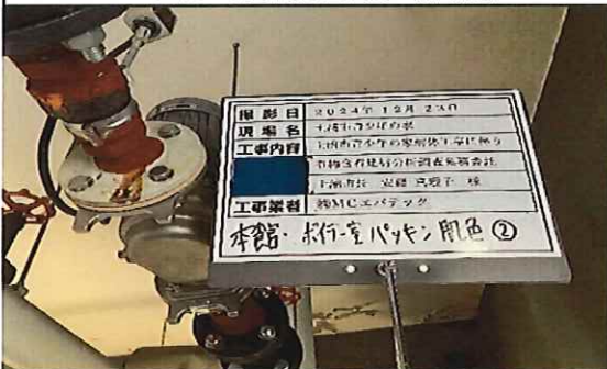
本館 ボイラー室 1階 配管 パッキン(色;肌色)② 採取前
