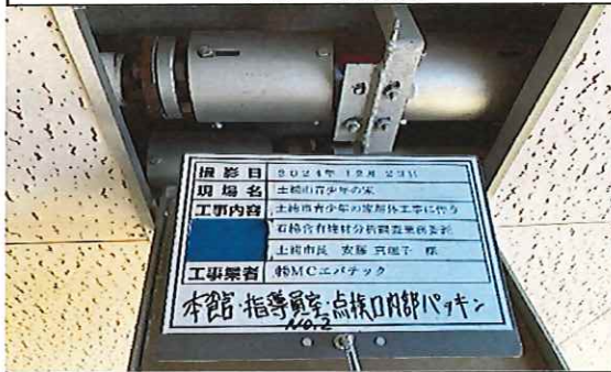
本館 指導員室No.2 1階 点検口内部 パッキン 採取後
