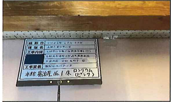
本館 宿泊室No.1 1階 床 ロンリウム(色;ピンク)① 補修後
