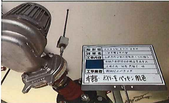
本館 ボイラー室 1階 配管 パッキン(色;肌色)① 採取前
