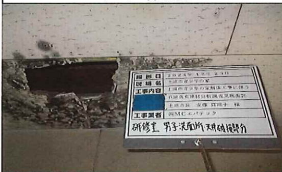
研修室 男子洗面所 1階 天井破損部分 ボード 採取後
