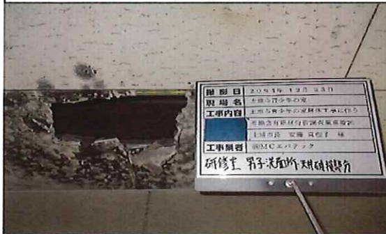
研修室 男子洗面所 1階 天井破損部分 ボード 採取前
