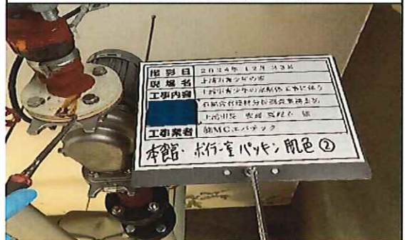
本館 ボイラー室 1階 配管 パッキン(色;肌色)② 採取中
