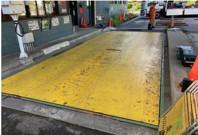
計量器（整備前）
