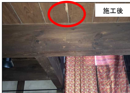
まちかど蔵「大徳」袖蔵1階天井(2階床)木材剥離修繕
