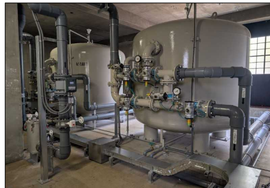
更新した濠水浄化施設のタンク
