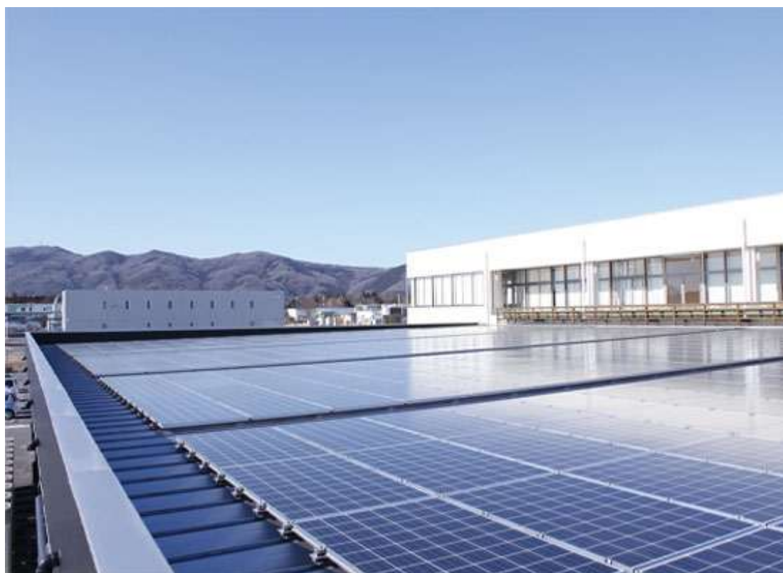
太陽光パネル
